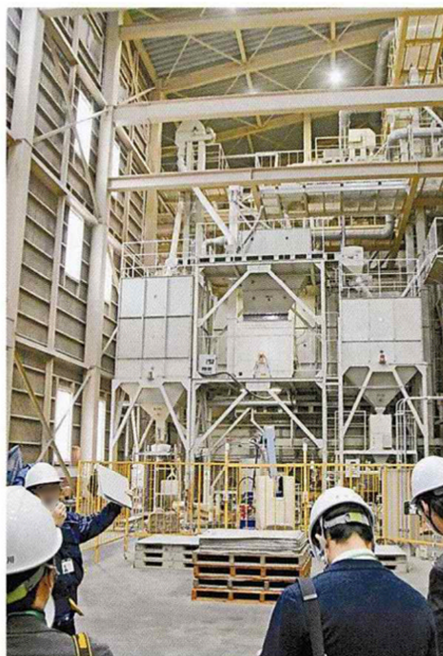
新篠津村農協の米乾燥調製施設「ライスファクトリー新しのつ」内にある異物除去施設。高品質なコメ輸出を支えている
